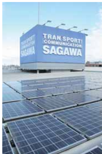
太陽光発電システム
